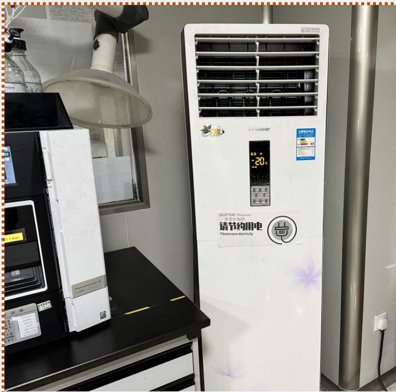
空调设备节能提示
