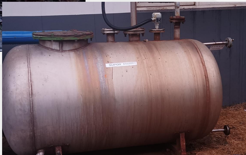
冷凝液收集罐
